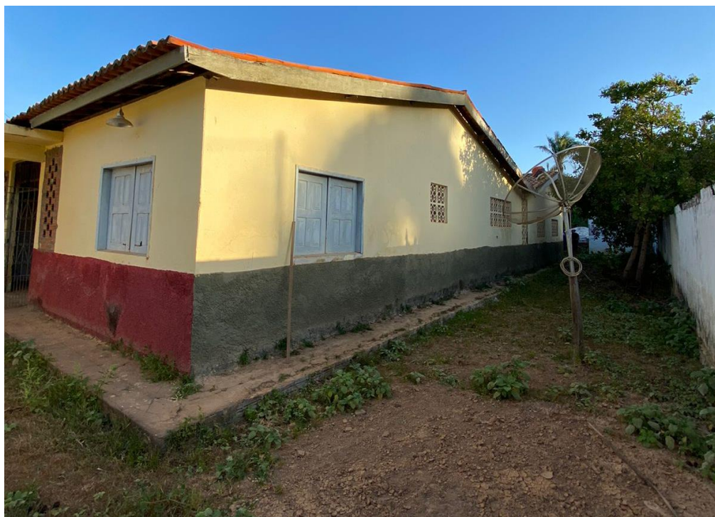
Parede lateral com infiltração e descamação de revestimento;
