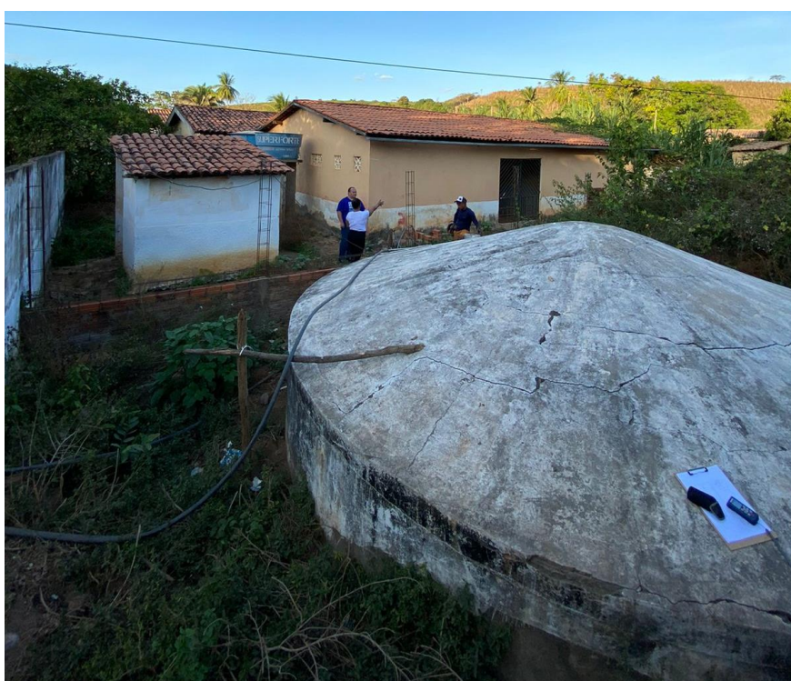
Cisterna de água com rachaduras e infiltrações e próxima da fossa séptica;
