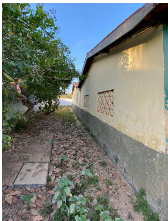
Parede lateral com descamação de revestimento;
