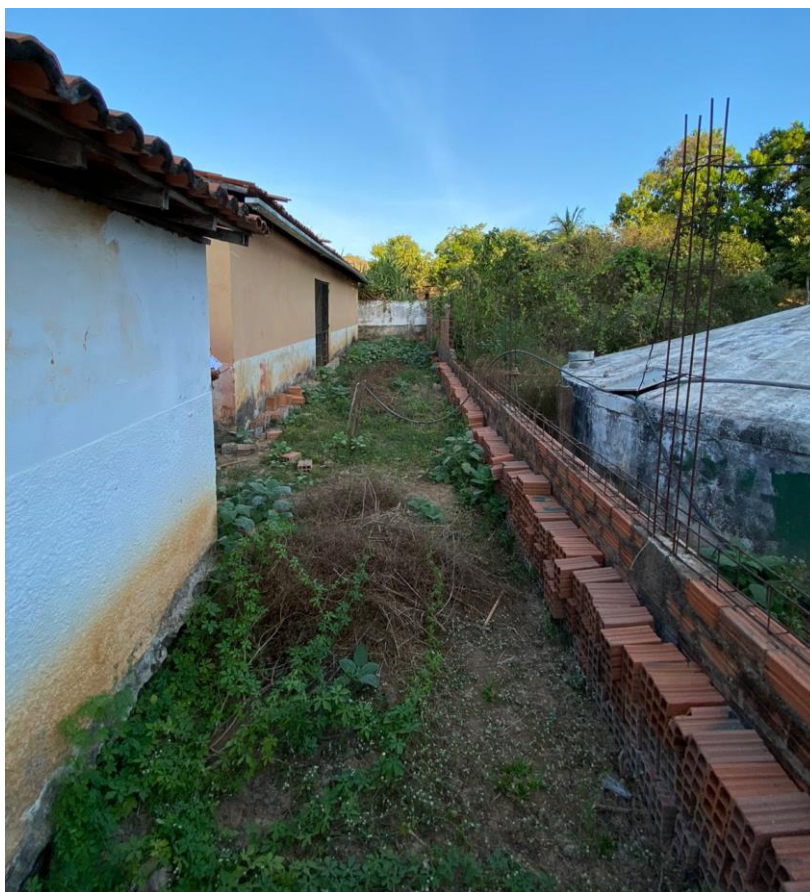
Início de uma viga baldrame sem término;
