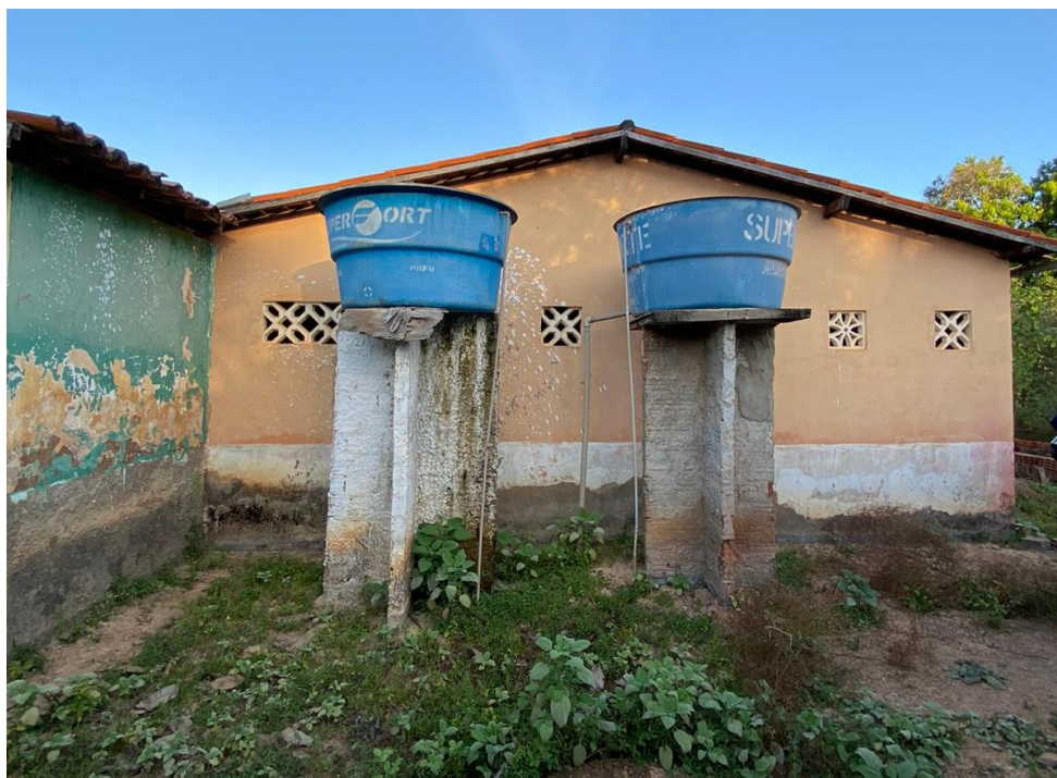
Estrutura da caixa d'água com infiltrações e partes quebradas;
